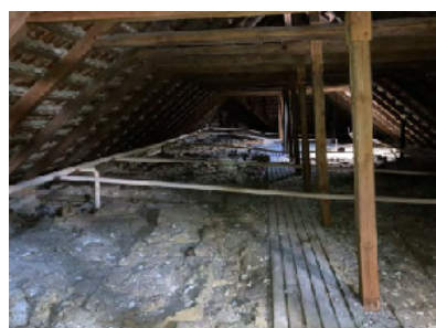
Isolering trykket ned, rester af understrykning fra taget.
